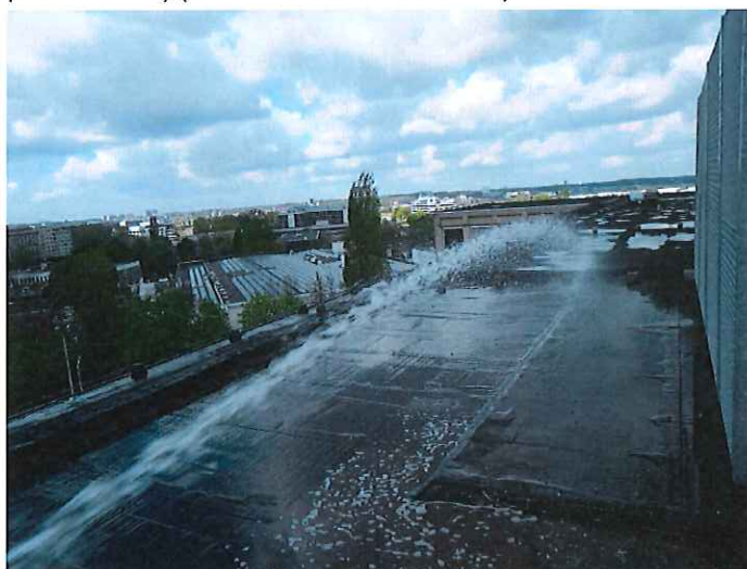
Test hydrant blok 1 7 de verdiep
